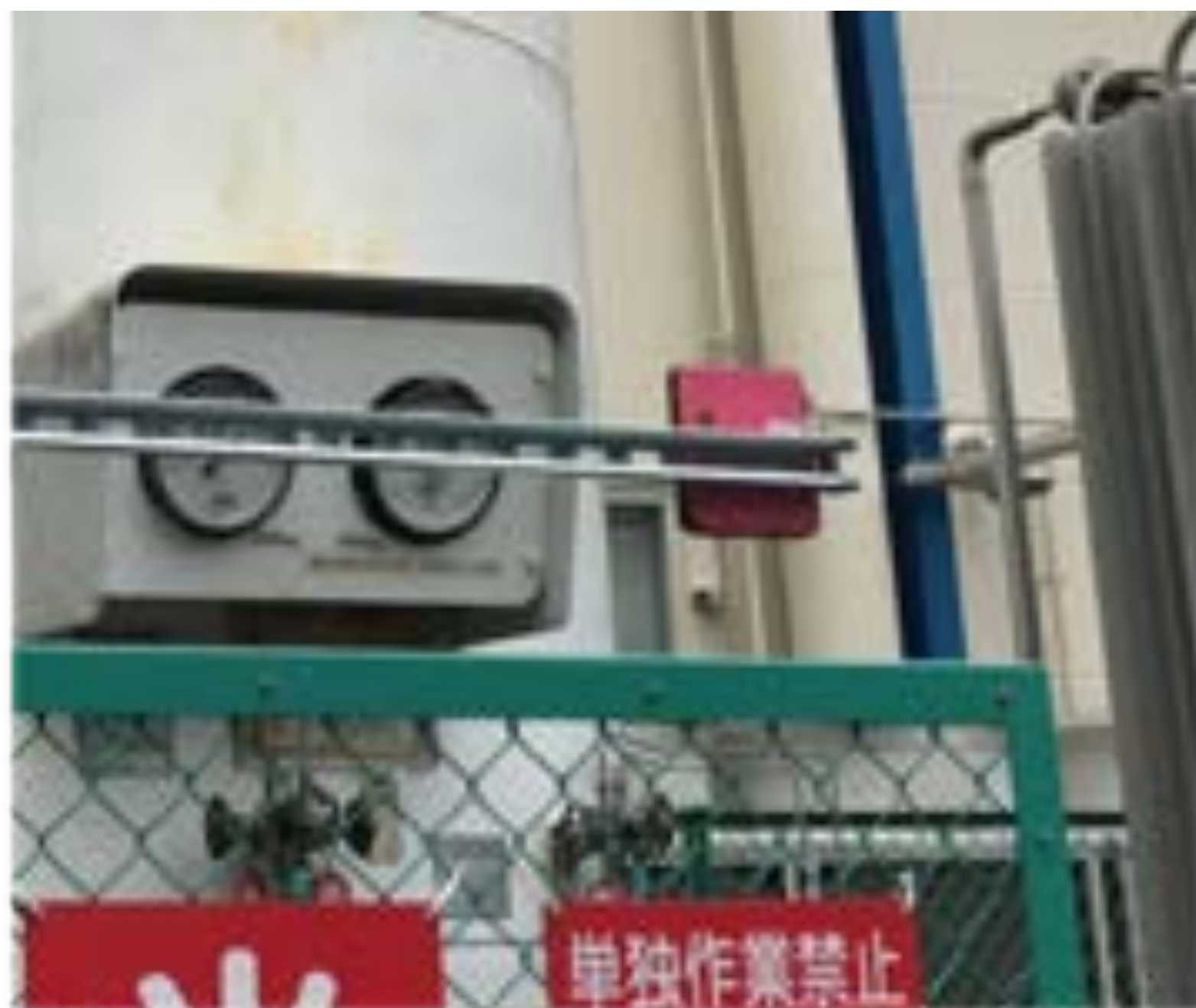
外部タンクメーター
